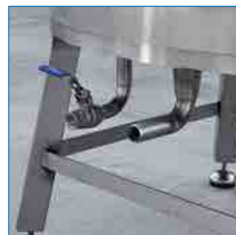
Carico - scarico acqua
